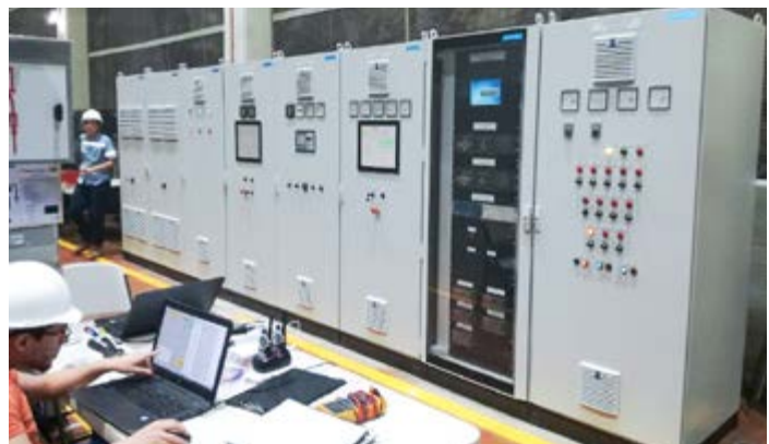
Control, protection, and regulation system at the 5 de Noviembre hydropower plant, El Salvador
