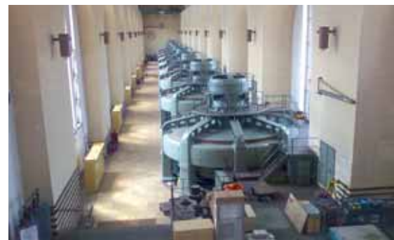
▼ Vue de la salle des machines de la centrale de Kachlet
