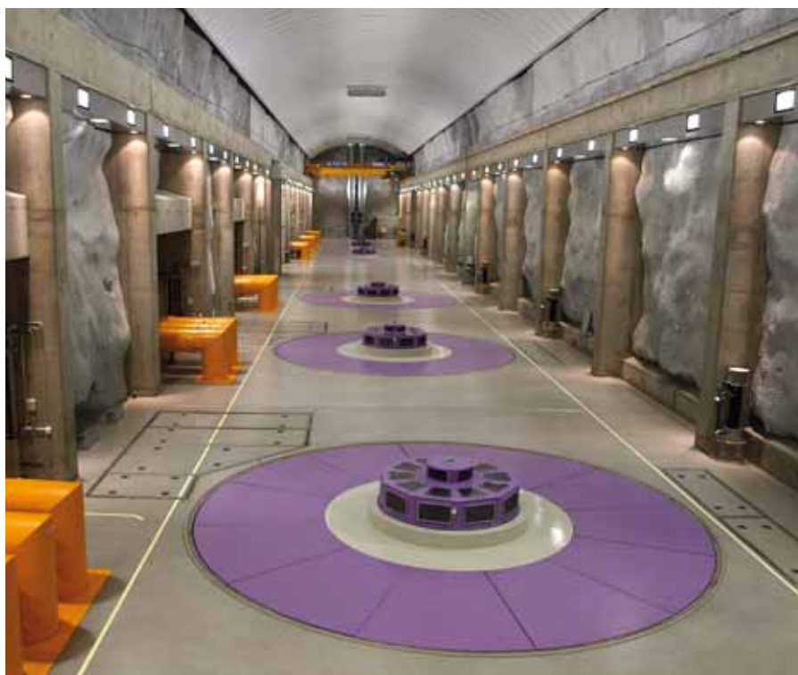
▼ La salle des machines après la mise en service
