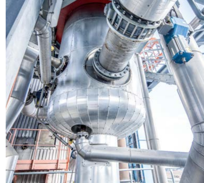
汽相再沸器利用高温黑液（闪蒸汽）的热能产生清洁蒸汽，并将闪蒸汽冷凝水分馏为富含松节油的冷凝水和清洁的冷凝水。
