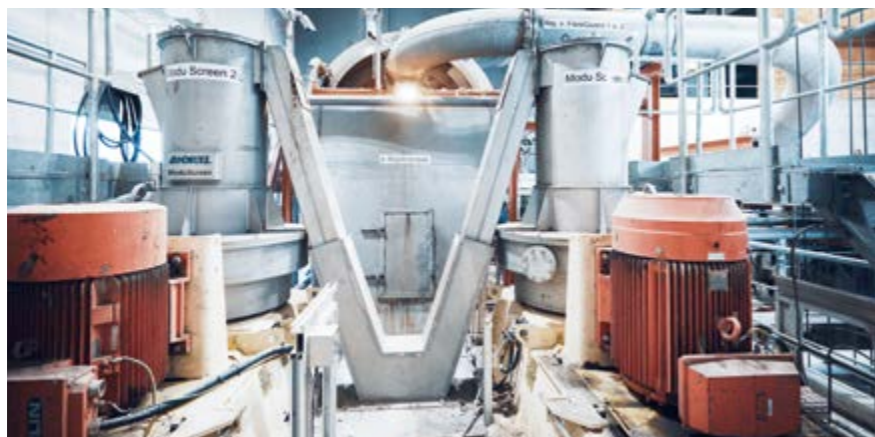
安德里茨ModuScreen TD粗筛是浆料制备车间的一部分
